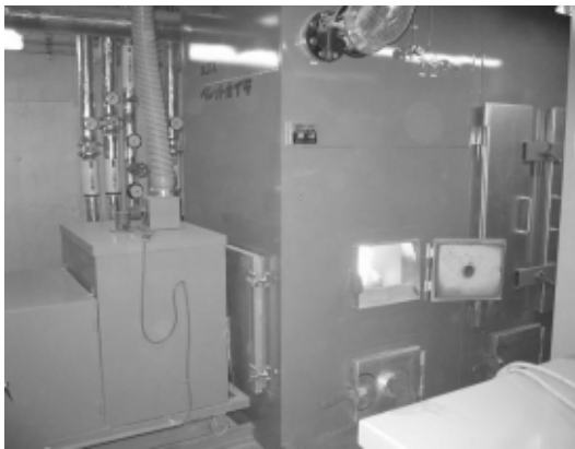
ペレットボイラー（アットホームくずまき）
