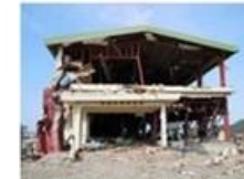
被害を受けた吉里吉里保育園の園舎。
